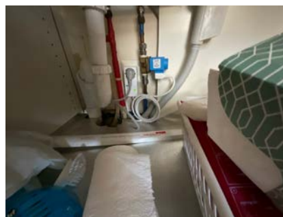
Kobber og plast (rør i rør)
