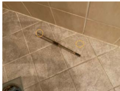
Bom under flis i dusjnische
