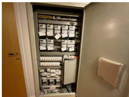
Hoved sikringsskap i fellesgang
