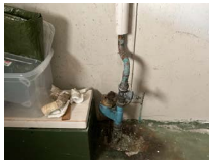
Hovedstoppekran for bygningen
