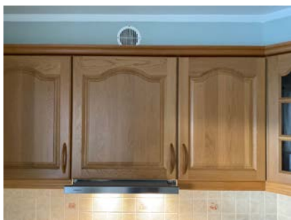
Kjøkkenventilator og utluft over overskap
