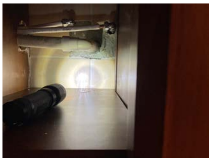
Avløp i servanten på badetrom
