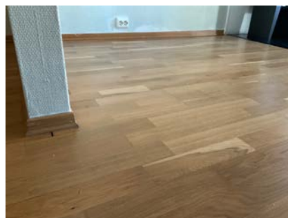
Glippe i gulv og manglende maling.
