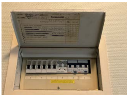
Sikringsskap i entree
