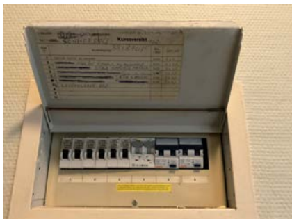
Sikringsskap i entree
