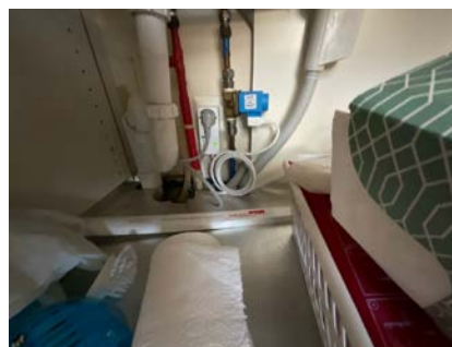
Kobber og plast (rør i rør)
