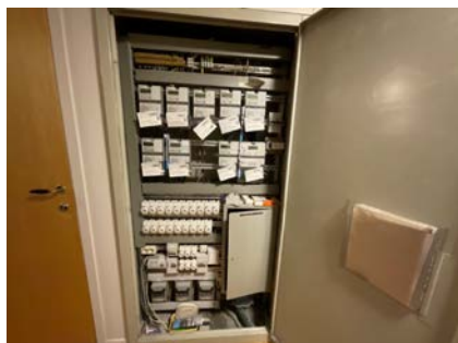
Hoved sikringsskap i fellesgang
