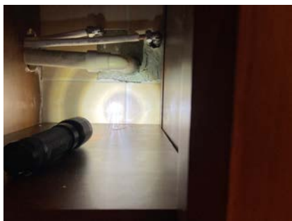
Avløp i servanten på badetrom
