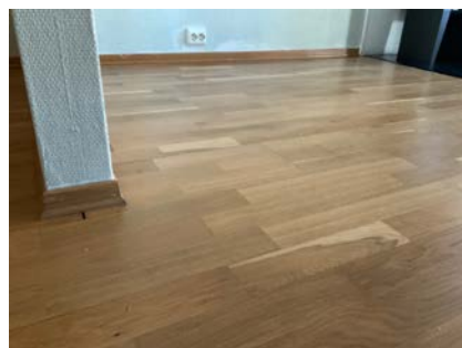
Glippe i gulv og manglende maling.
