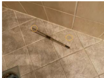
Bom under flis i dusjnische
