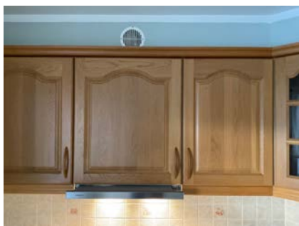
Kjøkkenventilator og utluft over overskap
