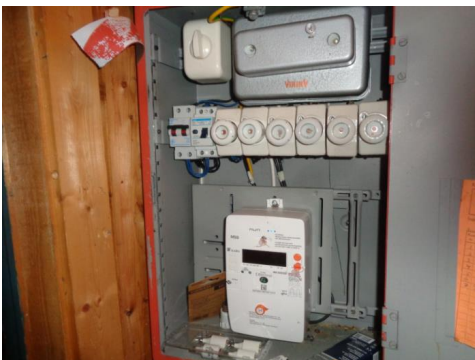
Sikringsskap i gang.
