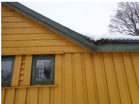
Råteskader på vindskier.
