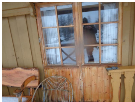
Elde og slitasje på altandører.
