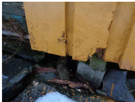
Råteskader på kledning.
