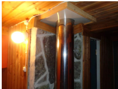
Stålpipes i gang. Denne står noe skjevt i konstruksjonene.
