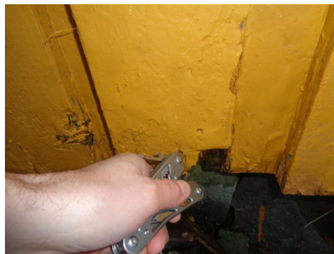
Råteskader på kledning.
