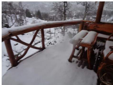
Store åpninger i rekkverk.
