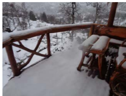
Store åpninger i rekkverk.
