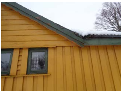
Råteskader på vindskier.
