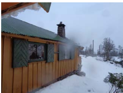
Det er ikke montert takrenner eller nedløp på boligen.
