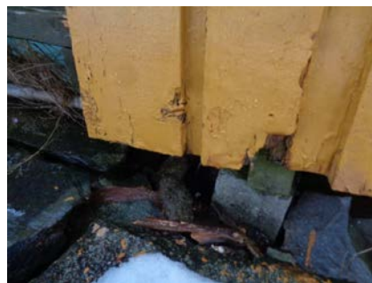
Råteskader på kledning.
