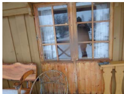
Elde og slitasje på altandører.
