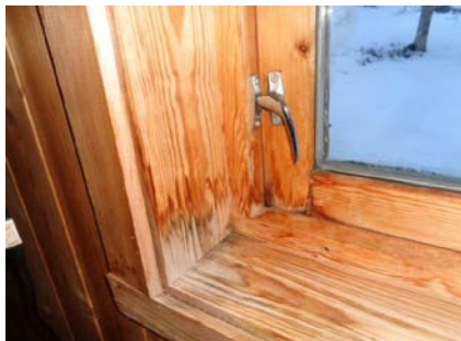
Kondensmerker i vindusposter og i karmen.
