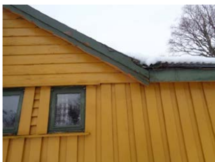
Råteskader på vindskier.
