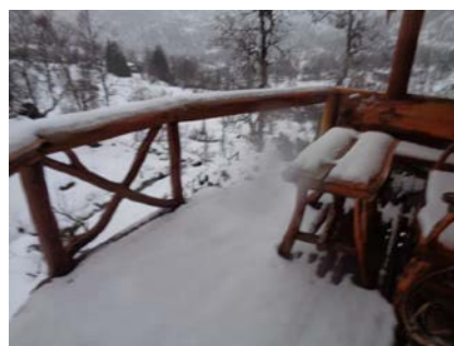
Store åpninger i rekkverk.
