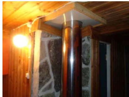
Stålpipe i gang. Denne står noe kjevt i konstruksjonene.
