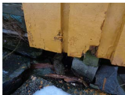
Råteskader på kledning.
