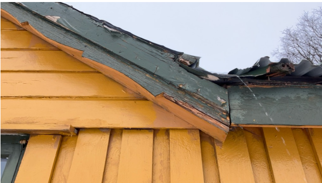
Råteskader på vindskier.
