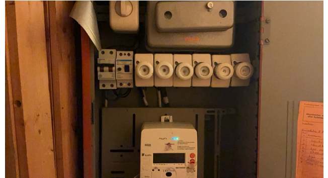
Sikringsskap i gang.
