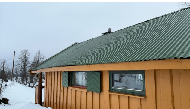
Det er ikke montert takrenner.
