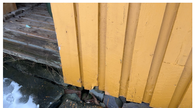
Stedvis noe råteskader på kledning.
