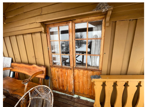
Eldre altandør til stue. Slitte overflater.
