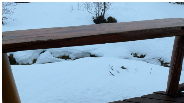
Store åpninger i rekkverk på altan.
