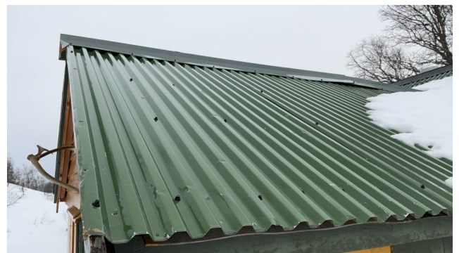
Eldre takplater med bulker.
