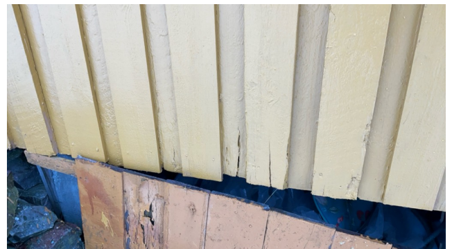
Stedvis skader på kledning.
