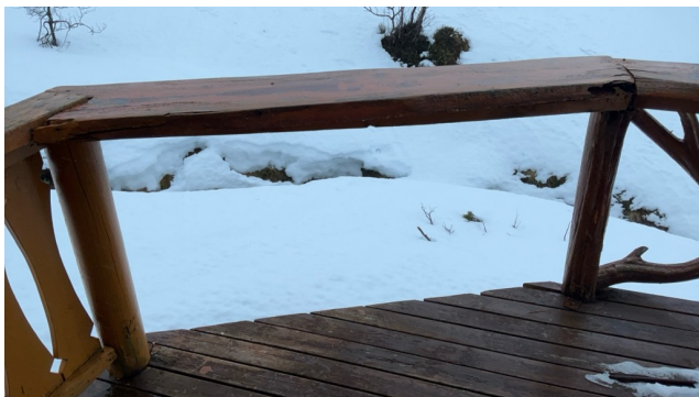
Store åpninger i rekkverk på altan.
