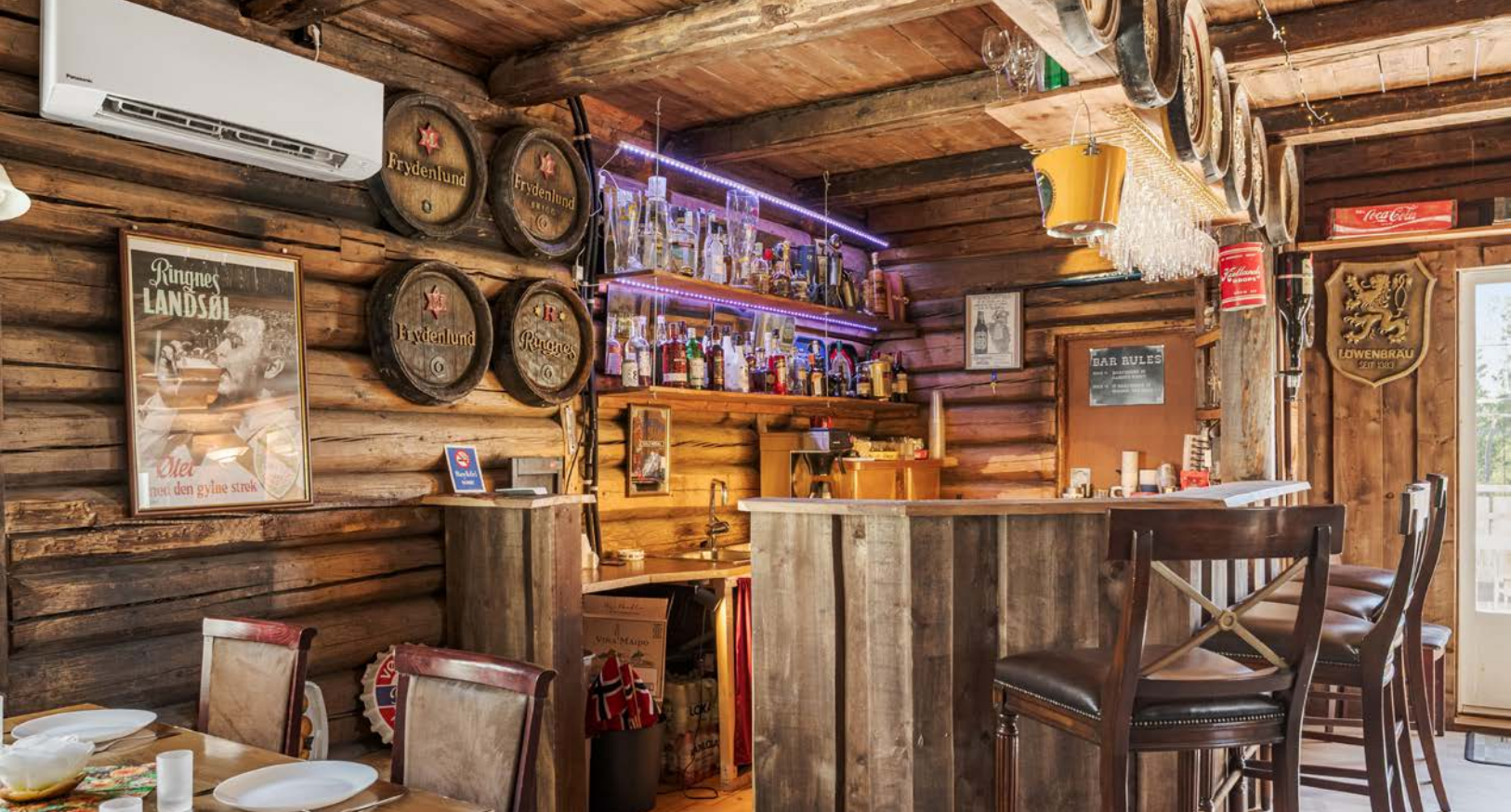
Luft-til-luft varmepumpe fra 2018 montert i 2023.
