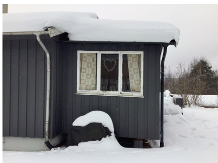
Overbygget terrasse har skjevheter.
