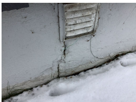
Eksempel på utvendig skråriss.
