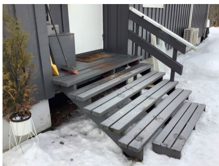
Trapp mangler rekkverk på en side.
