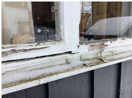
Eksempel på værslitte vinduer.
