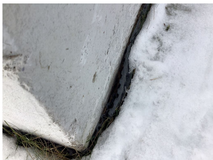
Utett overgang mellom fuktsperre og grunnmur.
