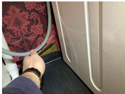
Eksempel på løsnet våtromstapet.
