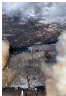
Hulltaking, og det er påvist muggdannelse og råteskader.
