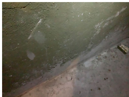
Eksempel på saltutslag på grunnmur.
