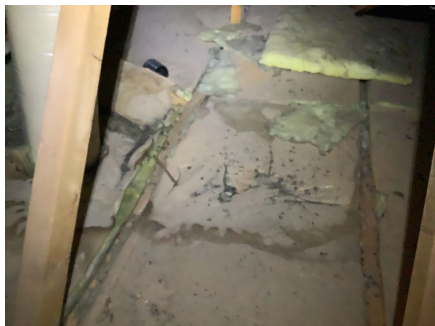
Eksempel på fuktskjolder på papir på isolasjonen.
