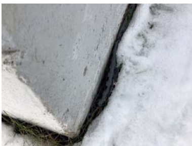
Utett overgang mellom fuktsperre og grunnmur.
