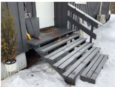
Trapp mangler rekkverk på en side.
