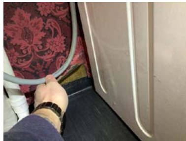
Eksempel på løsnet våtromstapet.
