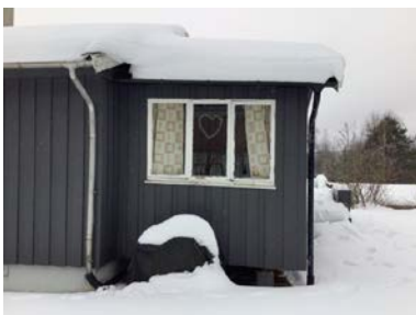
Overbygget terrasse har skjevheter.
