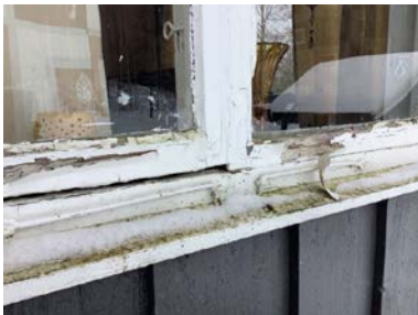
Eksempel på værslitte vinduer.
