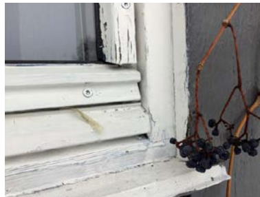
Eksempel på værslitt vindu.
