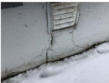
Eksempel på utvendig skråriss.
