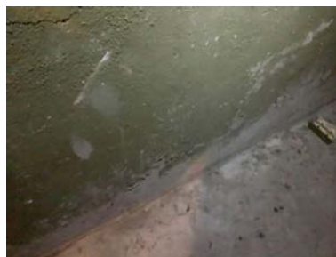
Eksempel på saltutslag på grunnmur.
