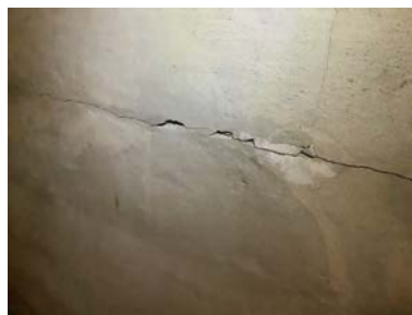
Eksempel på innvendig horisontalriss.
