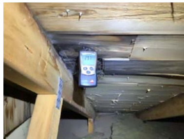
Taktro er våt inntil luftehatt.
