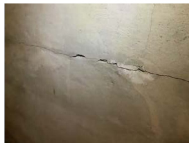
Eksempel på innvendig horisontalriss.
