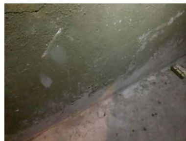
Eksempel på saltutslag på grunnmur.
