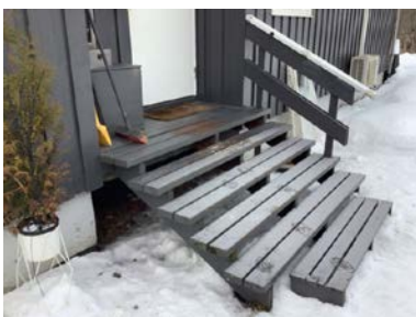
Trapp mangler rekkverk på en side.
