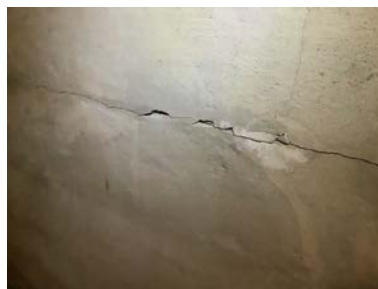
Eksempel på innvendig horisontalriss.
