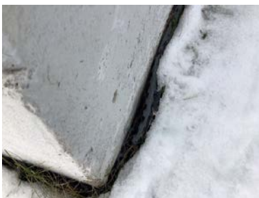
Utett overgang mellom fuktsperre og grunnmur.
