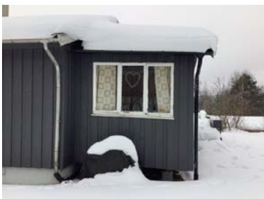
Overbygget terrasse har skjevheter.
