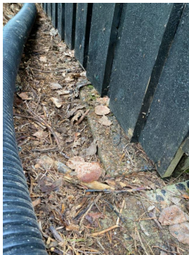
Veggkonstruksjon og kledning ligger lavt/nedpå terreng.
