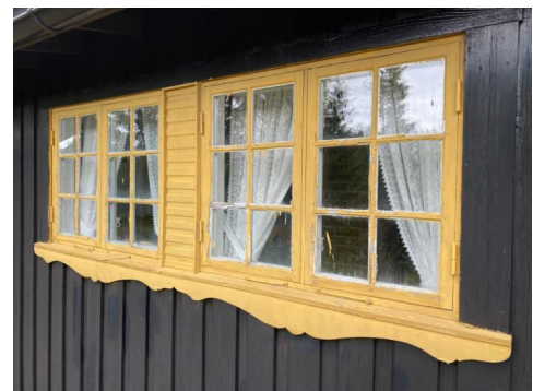
Gamle og værslitte vinduer.
