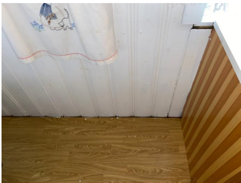
Manglende gulvlister på kjøkken/sov.
