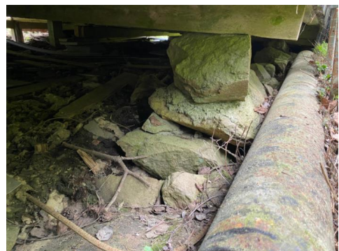
Ustabile pilarer i stablet naturstein med skjevheter
