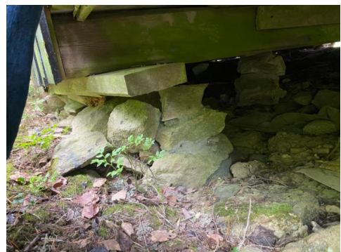
Ustabile pilarer i stablet naturstein med skjevheter
