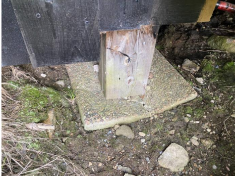
Knukket betonghelle/såle og nedsunken i terrenget
