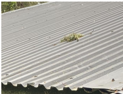
Små bulker i takplater
