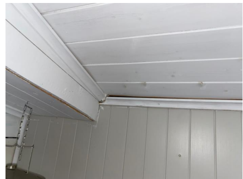
Skjevheter i tak/veggkonstruksjoner
