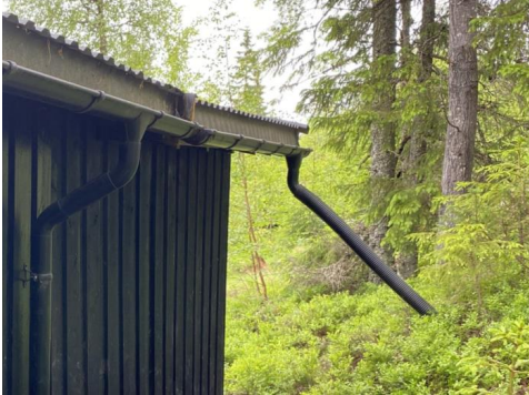
Skjevheter/feil fall på takrenner og nedløp av drensør i plast.
