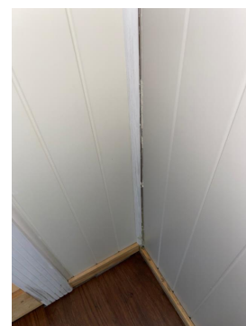
Skjevheter i tak/veggkonstruksjoner
