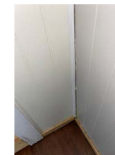
Skjevheter i tak/veggkonstruksjoner
