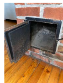
Sotluke nærmere gulv/brennbart materiale enn 30 cm og mangler ildfast plate under.
