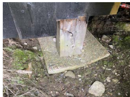
Knukket betonghelle/såle og nedsunken i terrenget
