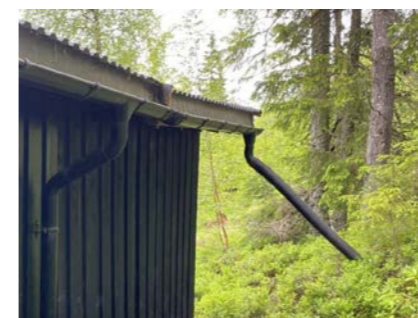
Skjevheter/feil fall på takrenner og nedløp av drenerør i plast.
