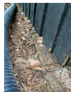
Veggkonstruksjon og kledning ligger lavt/ned på terreng.
