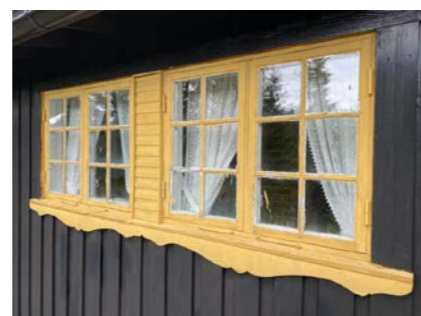
Gamle og værslitte vinduer.
