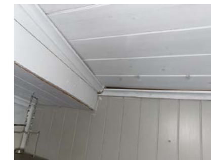
Skjevheter i tak/veggkonstruksjoner
