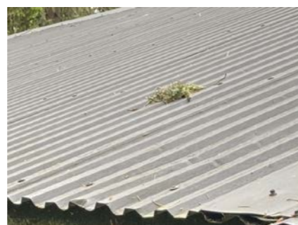
Små bulker i takplater
