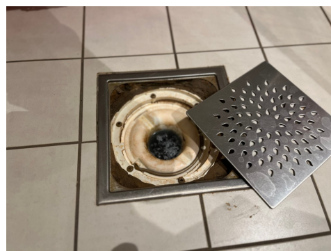
Sluk i dusjsone.
