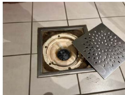
Sluk i dusjsone.
