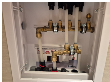
Fordelerskap på bad.
