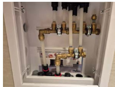
Fordelerskap på bad.
