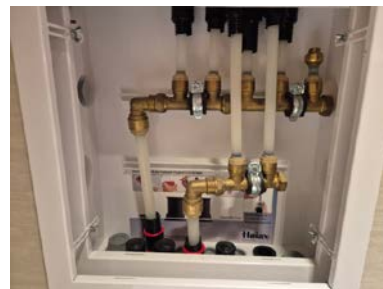
Fordelerskap på bad.
