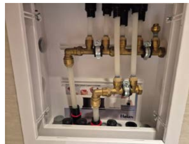
Fordelerskap på bad.
