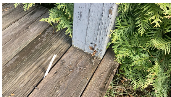
Begynnende råte på søyle.
