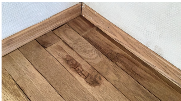
Fuktskade på gulv i gang ved dør til bad.
