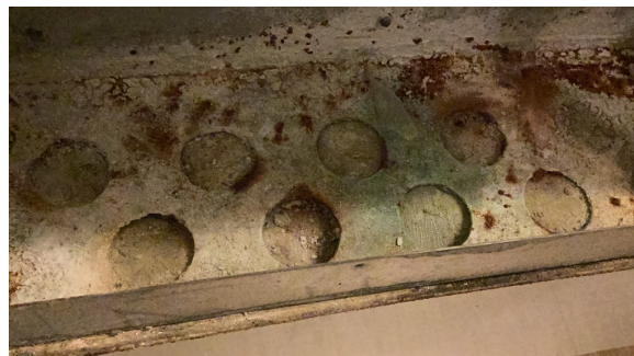
Det er utett i bunn på fordelerskap.
