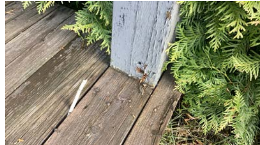
Begynnende råte på søyle.
