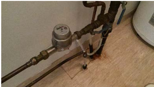
Vanninntak med måler og stoppekran.
