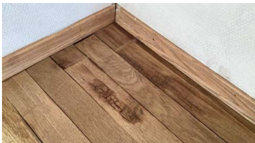
Fuktskade på gulv i gang ved dør til bad.
