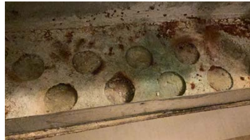
Det er utett i bunn på fordelerskap.
