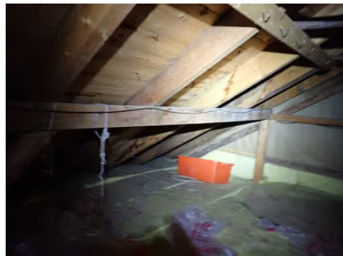
Det er flere steder plassert baljer for oppsamling av vann
