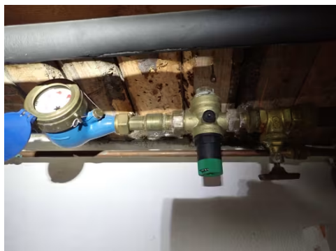
Stoppekrane er plassert i tak i vaskekjeller.
