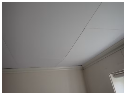
Nedbøyning i himlingsplater på soverom 2.
