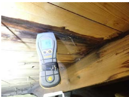
Taktro med råte, det er ikke målt fukt i taktro.
