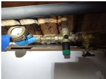
Stoppekrane er plassert i tak i vaskekjeller.
