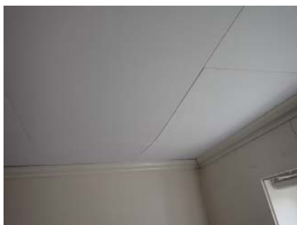
Nedbøyning i himlingsplater på soverom 2.
