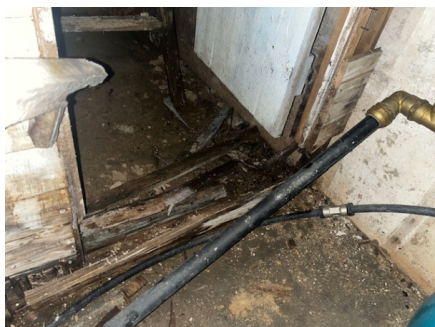
Råteskade i delevegg.
