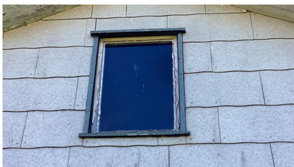
Eksempel på slitasje.
