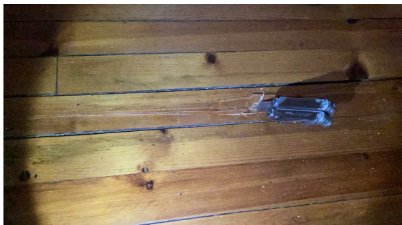
Råteskade i tregulv.
