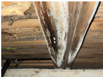
Råte i bjelke over kjeller.
