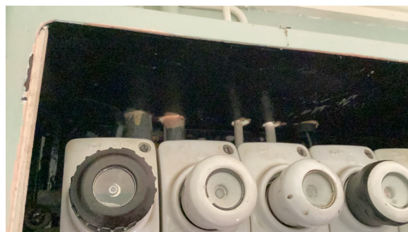
Utett rundt gjennomføringer i skap.
