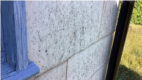
Eksempel på misfarging.
