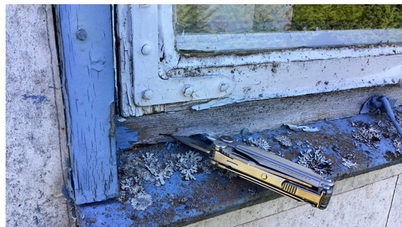
Eksempel på råte.
