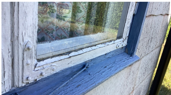
Eksempel på slitasje.
