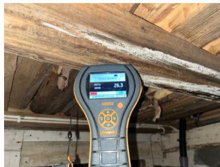
Skadelig fuktinnhold i treverk.
