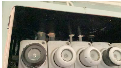
Utett rundt gjennomføringer i skap.
