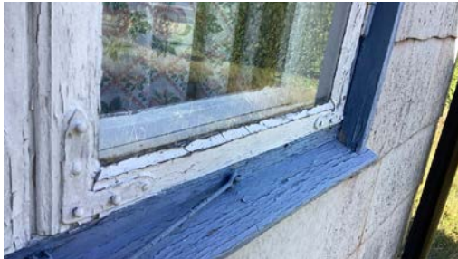
Eksempel på slitasje.
