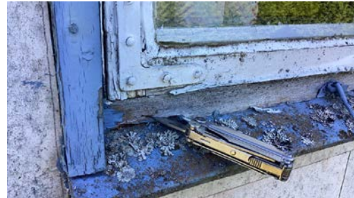
Eksempel på råte.
