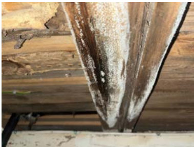
Råte i bjelke over kjeller.
