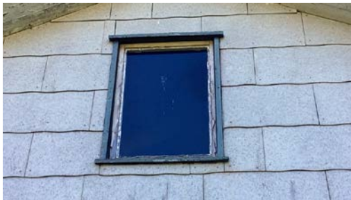
Eksempel på slitasje.
