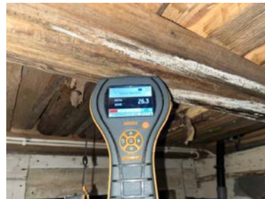
Skadelig fukttinnhold i treverk.
