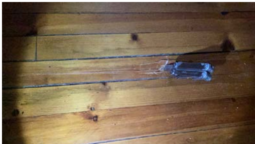
Råteskade i tregulv.
