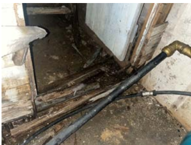
Råteskade i delevegg.
