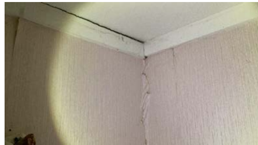
Eksempel på oppsprekking i tapet.
