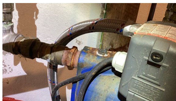
Rust på utstyr.
