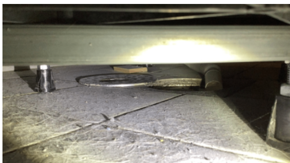
Sluk under dusjkabinett.
