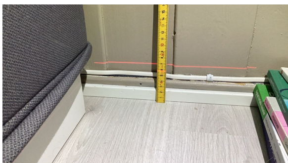
Det ble målt helningsavvik på 18 mm på soverom i loftsetasje.
