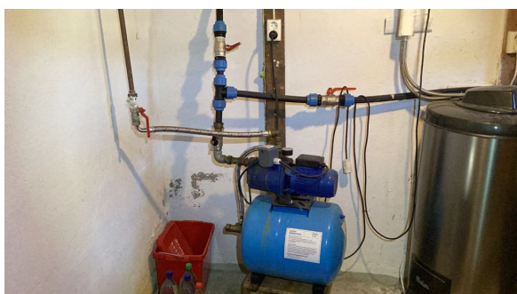
Stoppekran lokalisert på gang i kjeller.
