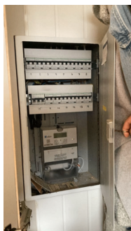
Sikringsskap lokalisert i skap i gang.
