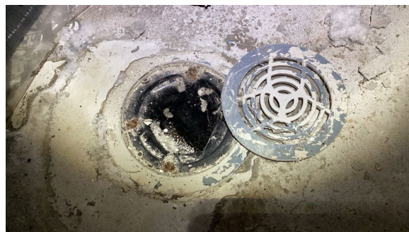
Plastsluk på bod i kjeller.
