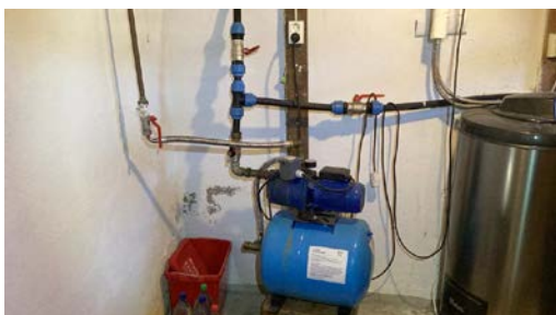
Stoppekran lokalisert på gang i kjeller.
