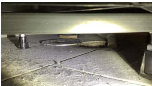
Sluk under dusjkabinett.
