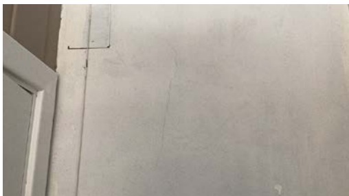
Riss i pipe.
