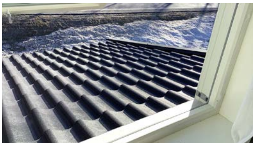
Tak over inngangsparti er 10°. Taktekkingen er ikke godkjent for legging på så lave takvinkler.
