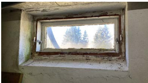
Kjellervinduer bærer preg av slitasje.
