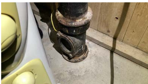
Stakeluke på bod i kjeller.
