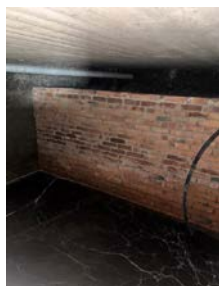
Deler av rom under terreng er tidligere systerne uten adkomst mulighet. Bildet er tatt via inspeksjonsluke og det er observert misfarging på gulv.
