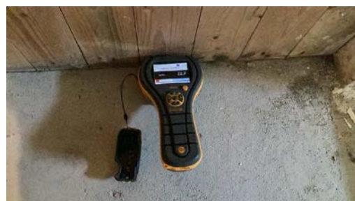
Fuktmåling ble foretatt, jeg målte skadelig fukt.
