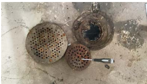
Sluk på bod i kjeller.
