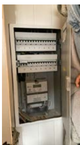
Sikringsskap lokalisert i skap i gang.
