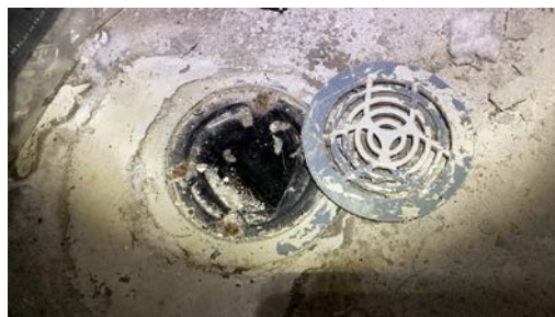
Plastsluk på bod i kjeller.
