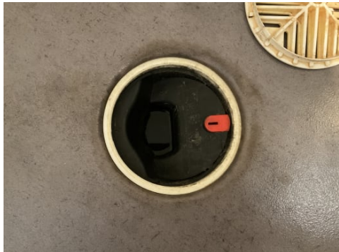
Sluk i dusjsonen. Plastsluk med synlig klemring, tetsjikt er et belegg.
