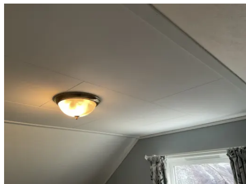
Manglende luke opp til hulrom over hanebjelker.
