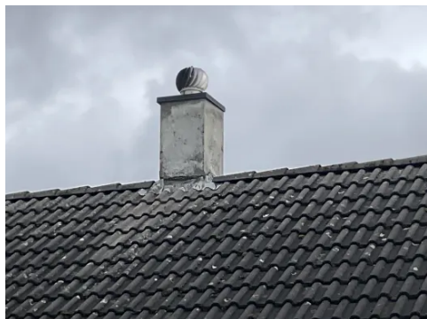
Pipen er noe værslitt, noe malingsavflassing.
