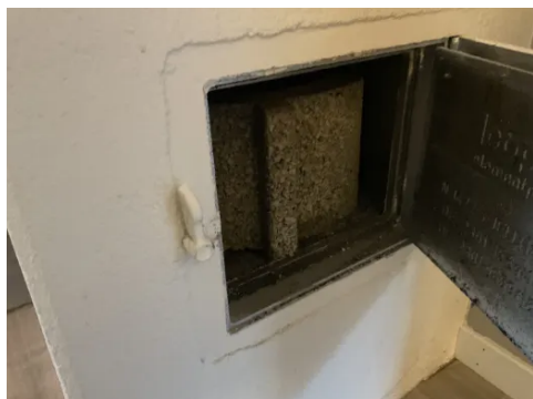
Det er montert sotstein.
