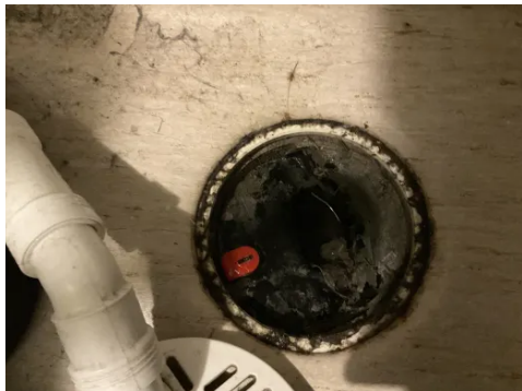
Plastsluk fra byggeår, synlig klemring, tetsjikt er belegg. Sluk bør rengjøres.
