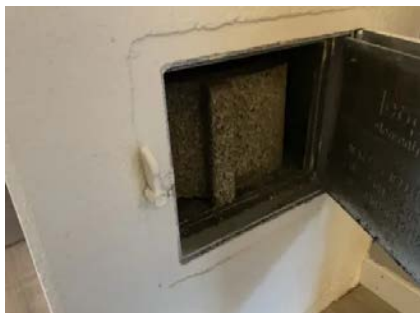
Det er montert sotstein.
