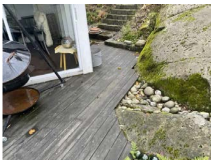
Terrassebord ligger helt inntil terreng.
