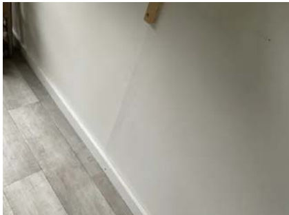
Noe ufagmessig utført sparkling.
