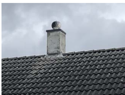
Pipen er noe værslitt, noe malingsavflassing.
