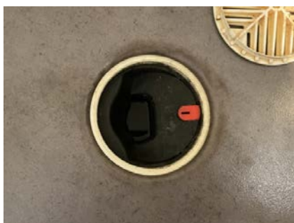
Sluk i dusjsone. Plastsluk med synlig klemring, tettsjikt er et belegg.
