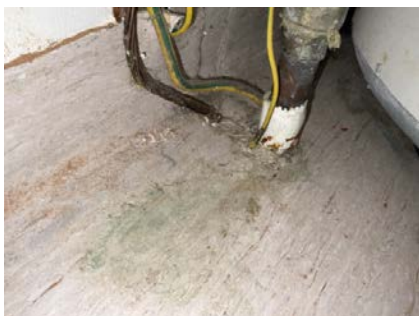
Ikke tilstrekkelig oppbrett rundt vannrør som kommer oppigjennom belegg.
