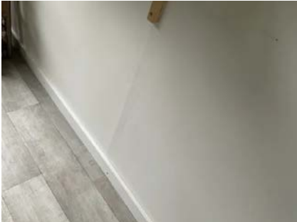
Noe ufagmessig utført sparkling.
