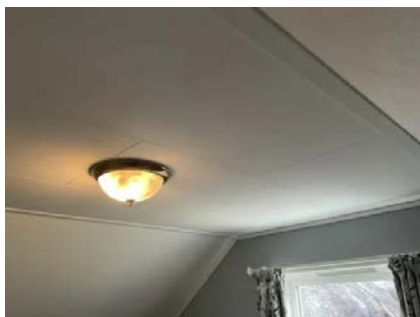
Manglende luke opp til hulrom over hanebjelker.
