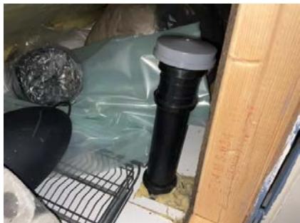
Det er montert tilbakeslagsventil på luftingen til avløp. denne er montert i kott.
