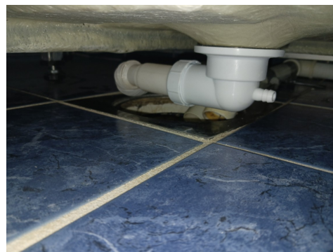
Gulvsluk plassert under kabinett
