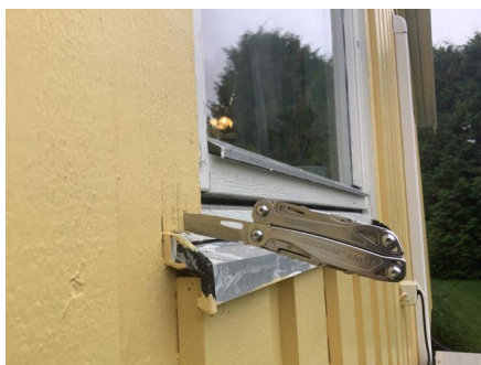
Eksempel på råteskadet bordkledning.
