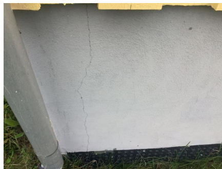
Eksempel på utvendig skråriss.
