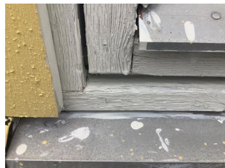
Eksempel på værslitt vindu.
