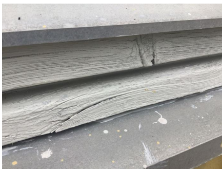
Eksempel på værslitt vindu.
