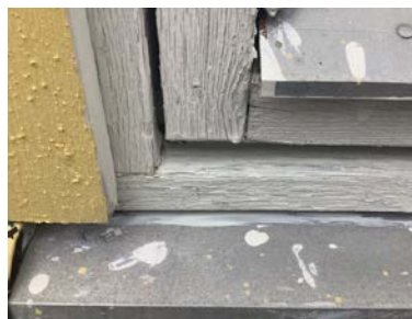
Eksempel på værslitt vindu.
