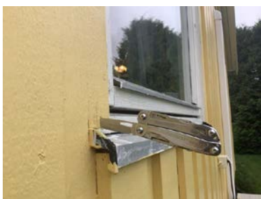
Eksempel på råteskadet bordkledning.
