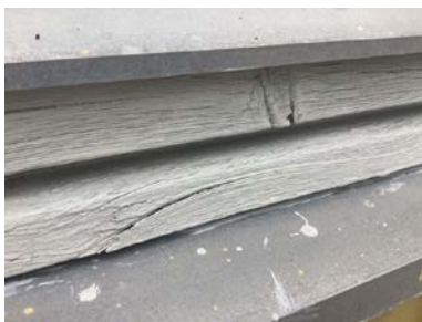
Eksempel på værslitt vindu.
