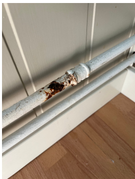
Dannelse av rust på rør til radiator
