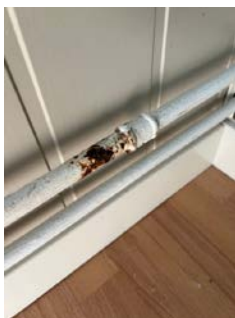
Dannelse av rust på rør til radiator
