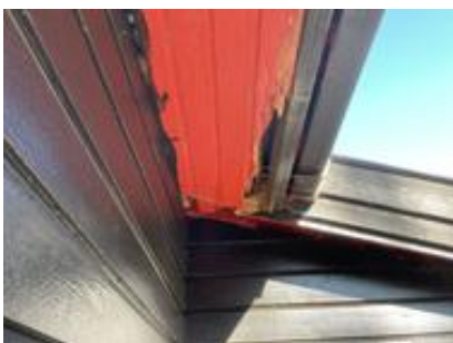
Betydelig råte i underkledning og i sutak her på baksiden.
