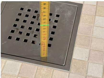
Fallforhold ca. 132 mm topp slukrist i dusjsone
