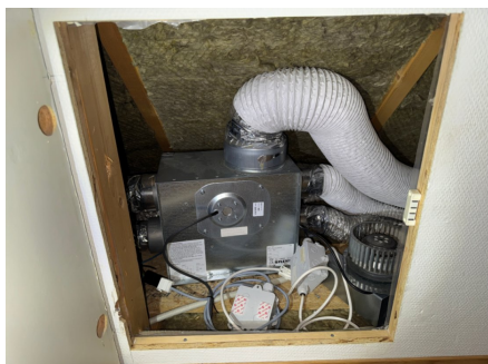
Luftbehandlingsaggregat i kryploft
