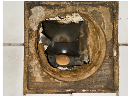
Sluk i stål fra byggeår
