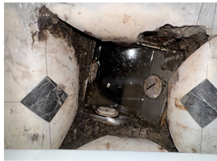
Sluk i stål fra byggeår
