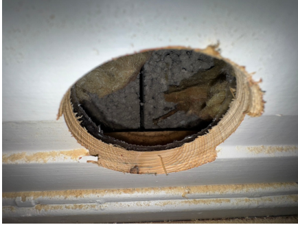
Hulltaking i kjellerstue sydøst hjørne
