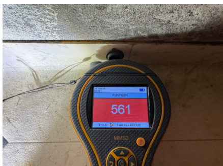
Fuktindikasjon på gulv ved grunnmur
