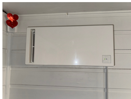
Balansert miniventilasjonsanlegg i kjellerstue
