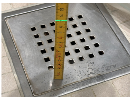
Fallforhold ca. 131 mm topp slukrist i dusjsone
