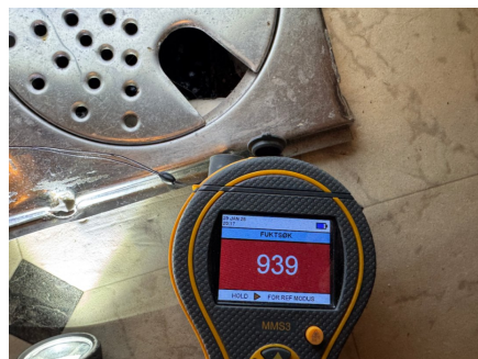
Fuktindikasjon på gulvet ved sluk
