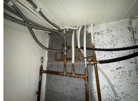
Vannrør i kobber og kobber med plastkappe
