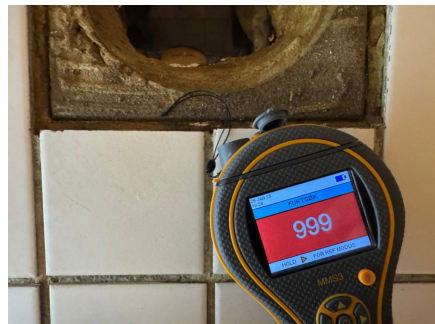
Fuktindikasjon på gulvet
