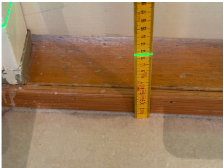
Fallforhold ca. 115 mm overkant gulv ved terskel
