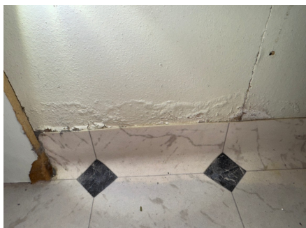
Blærer i malingsfilm og fukt-/svelleskadet dekkside til benkeinnredning
