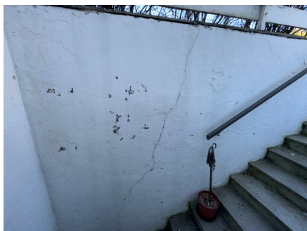
Sprekk, overflatesår og avskalling i maling på trappevang/mur
