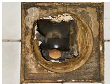
Sluk i stål fra byggeår
