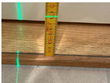
Fallforhold ca. 83 mm topp oppbrett membran ved terskel
