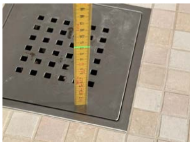
Fallforhold ca. 132 mm topp slukrist i dusjsone
