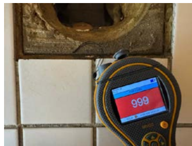
Fuktindikasjon på gulvet
