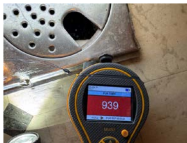
Fuktindikasjon på gulvet ved sluk
