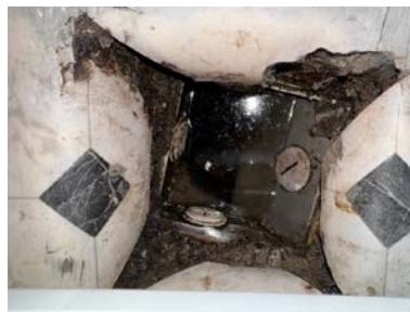
Sluk i stål fra byggeår
