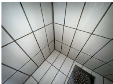
Svertesopp og muggsoppforekomster på overflater, flisfuger og silikofuger
