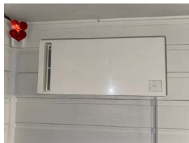
Balansert miniventilasjonsanlegg i kjellerstue
