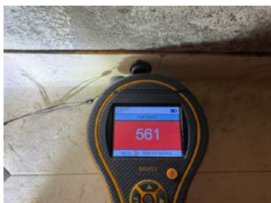
Fuktindikasjon på gulv ved grunnmur
