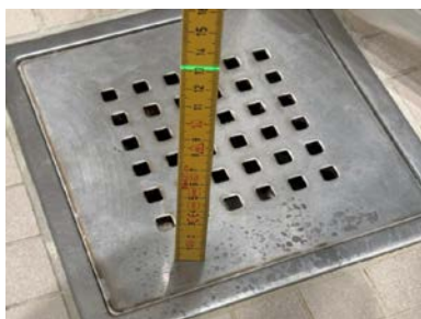
Fallforhold ca. 131 mm topp slukrist i dusjsone
