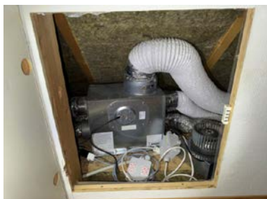
Luftbehandlingsaggregat i kryploft
