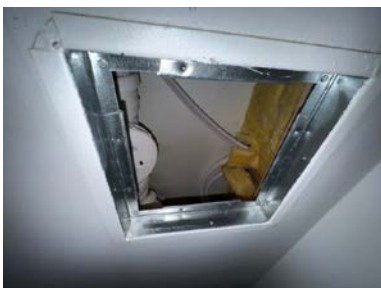
Inspeksjonsluke til stakepunkt i toalettrom
