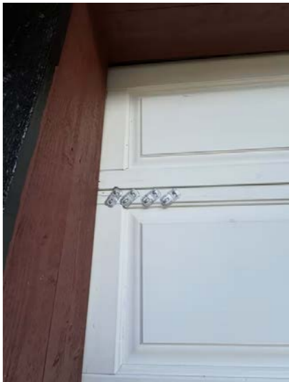
Porthar en mindre skade som er reparert.
