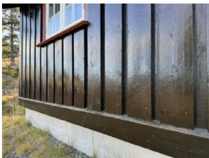
Stort sett hel og fungerende fasade.
