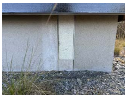
Mindre avvik på ringmurselementer.
