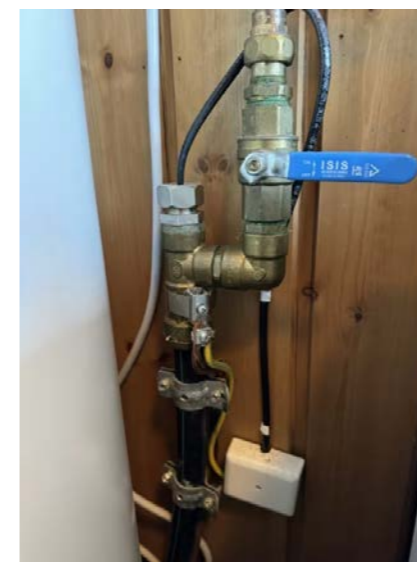
Stoppekran for vann med påført varmekabel.
