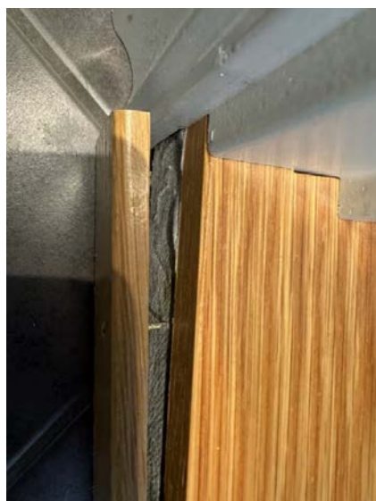
Synlig oppbrett av membran på terskel.
