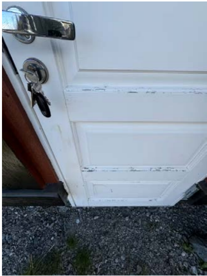
Slitasje på dør.
