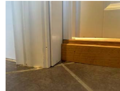
Oppkant ved terskel, oppbrett av membran er ikke påvist.
