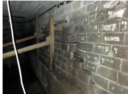
Grunnmur har kraftig sprekk og forskyvning innover.
