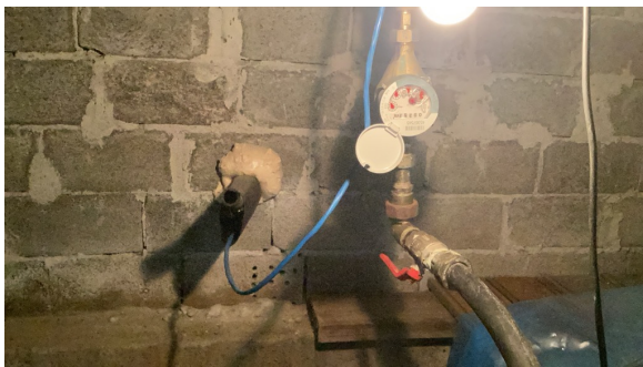
Vanninntak med måler og stoppekran i kjeller.
