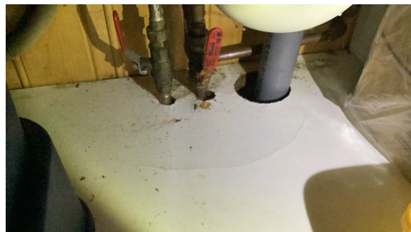
Eksempel på slitasje.
