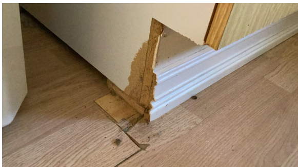
Eksempel på slitasje.
