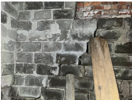
Kraftige sprekker i mur mot nord.
