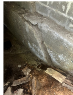
Fundament har kraftig sprekk og forskyvning innover.
