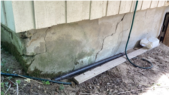
Eksempel på utvendige sprekker i grunnmur.
