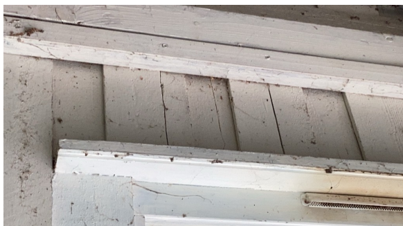
Eksempel på sprekker i kledningsbord.
