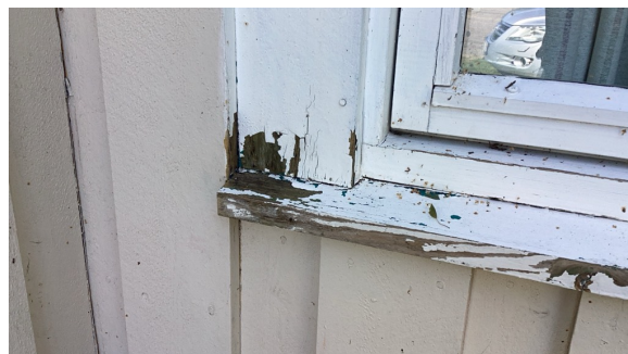
Eksempel på slitasje.
