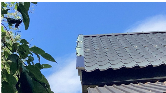
Eksempel på avskaling på beslag
