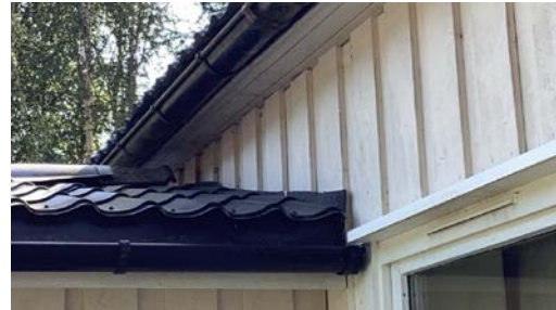
Overgang mellom tak og vegg over entre.
