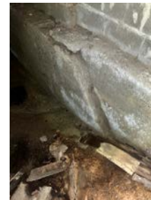
Fundament har kraftig sprekk og forskyvning innover.
