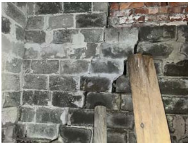
Kraftige sprekker i mur mot nord.
