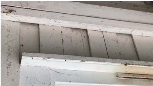
Eksempel på sprekker i kledningsbord.
