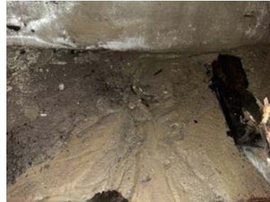
Tegn til at vann trenger inn under grunnmur mot øst.
