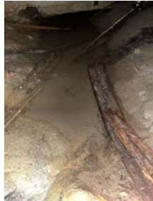
Vannansamling på bakken i kjeller.
