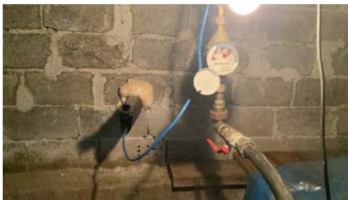
Vanninntak med måler og stoppekran i kjeller.
