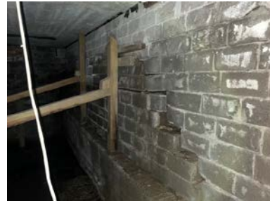
Grunnmur har kraftig sprekk og forskyvning innover.
