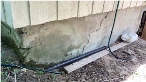
Eksempel på utvendige sprekker i grunnmur.
