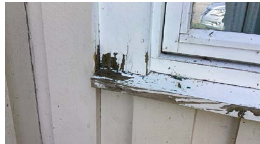
Eksempel på slitasje.
