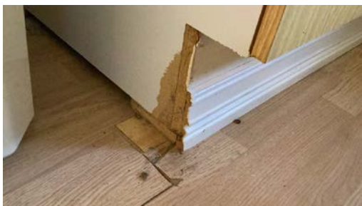
Eksempel på slitasje.
