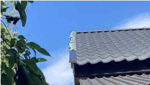
Eksempel på avskaling på beslag
