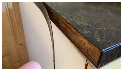
Eksempel på slitasje.
