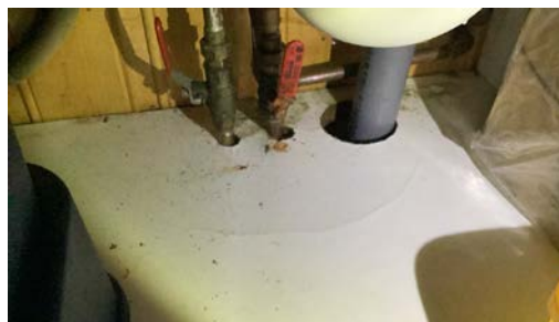
Eksempel på slitasje.
