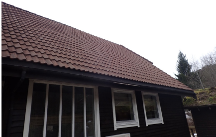
Snøfangere på taket er ikke montert.
