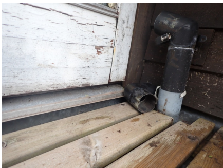
Fuktopptrekk i skyvedør.
