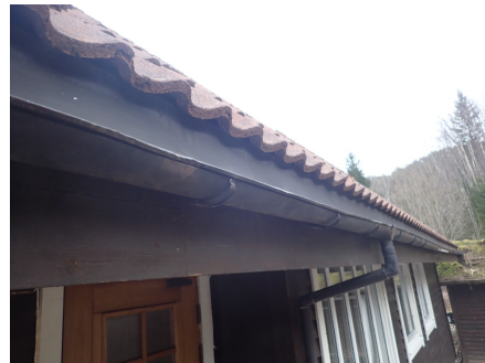
Deformasjoner i takrenner.
