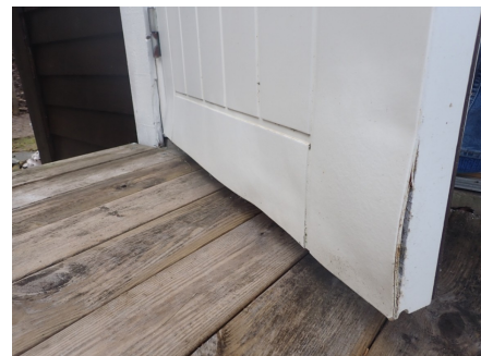
Fuktskader i kjøkkendør.
