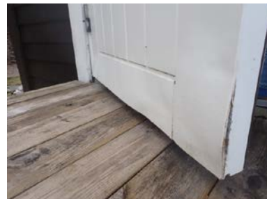
Fuktskader i kjøkkendør.
