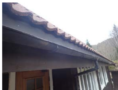
Deformasjoner i takrenner.
