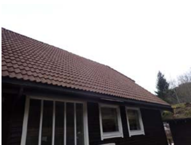
Snøfangere på taket er ikke montert.
