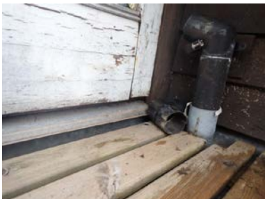
Fuktopptrekk i skyvedør.
