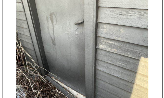
Døren er skadet og modent for utskifting
