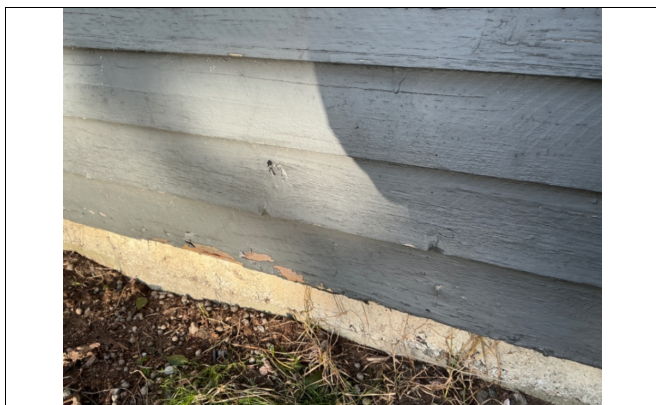
Sporadisk dårlige kledningsbord
