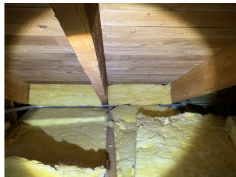
Manglende lufting på tilbygd del
