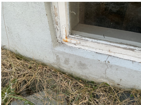
Flere kjellervinduer fra byggetid med enkle glass og slitasje
