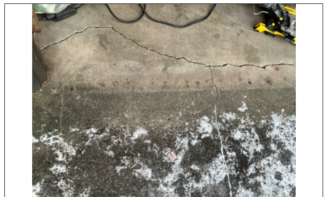
Setningssprekker i garasjegulv. Gulvet var i hovedsak tildekt med lagrede ting
