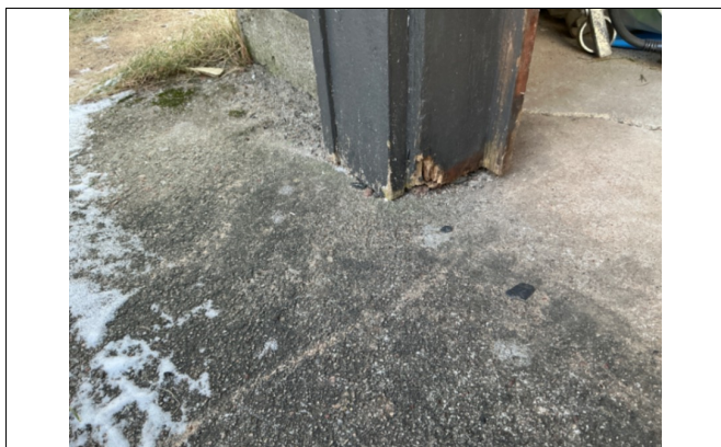
Treverk i kontakt med terreng gir økt slitasje
