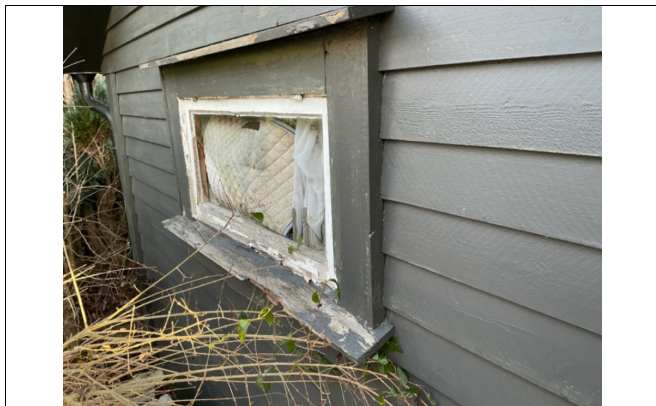
Knekt vindu er modent for utskifting
