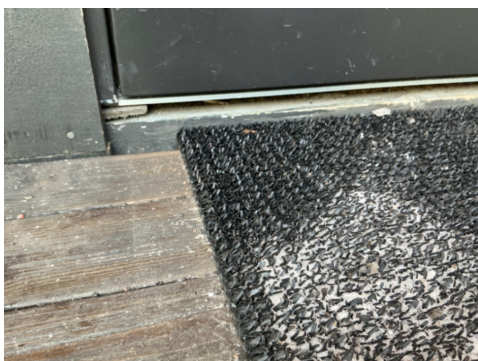
Det mangler svillbeslag på inngangsdør. Bør monteres
