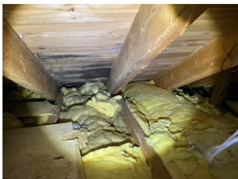
Svertemerker og kondens registrert ned mot gesimser
