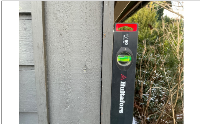
Loddavvik på yttervegger. Garasje har skjevheter
