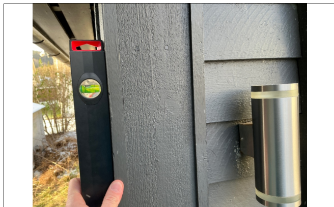
Loddavvik på yttervegger. Garasje har skjevheter
