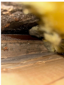
Synlig kondens/fukt inne i påforet vegg mot inngangsside
