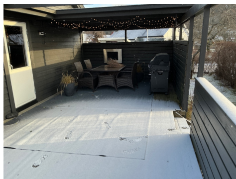
Snødekte flater på terrasse ved befaringen
