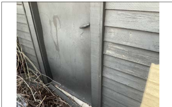
Døren er skadet og modent for utskifting
