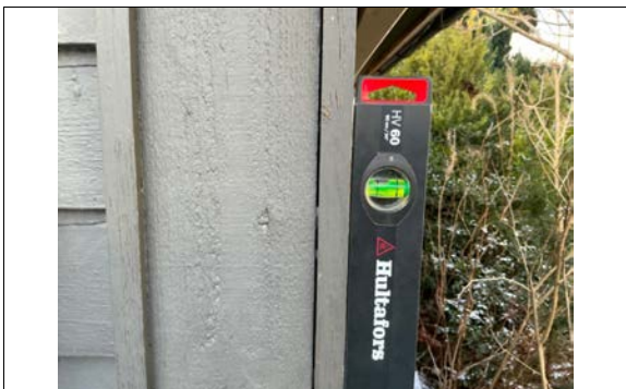
Loddavik på yttervegger. Garasje har skjevheter
