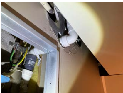
Manglende tetting ved gjennomføringer i vegg under vasken
