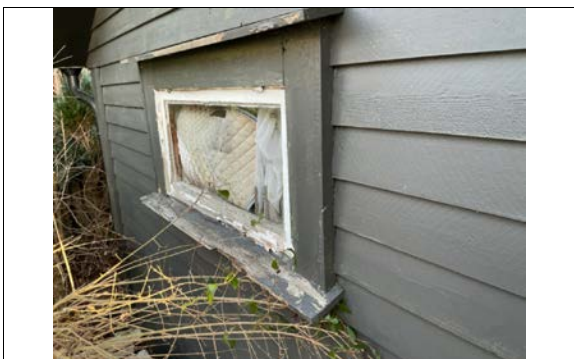
Knekt vindu er modent for utskifting
