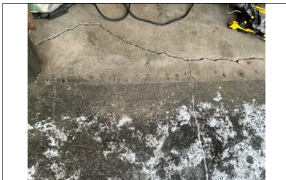
Setningssprekker i garasjeggulv. Gulvet var i hovedsak tildekt med lagrede ting
