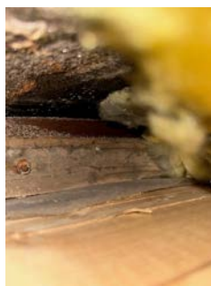
Synlig kondens/fukt inne i påføret vegg mot inngangsside
