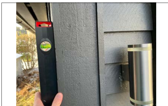
Loddavvik på yttervegger. Garasje har skjevheter
