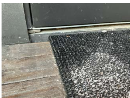
Det mangler svillbeslag på inngangsdør. Bør monteres
