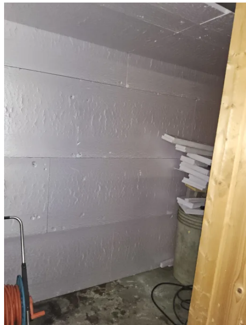
Bilde viser isopor på vegg/himlingsflater.
