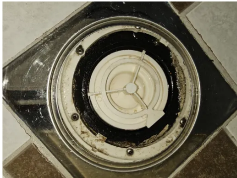
Bilde viser sluk.
