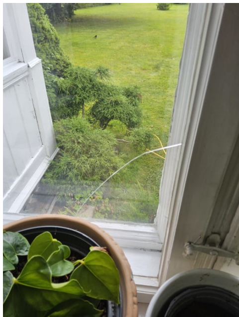
Bilde viser sprekk i glass.
