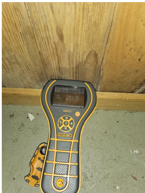
Bilde viser fuktmåling i utlektet kjellervegg.
