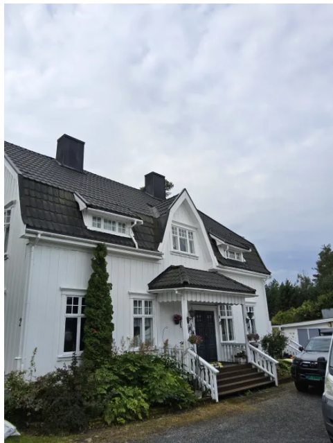
Bilde viser manglende bruk av snøfanger.
