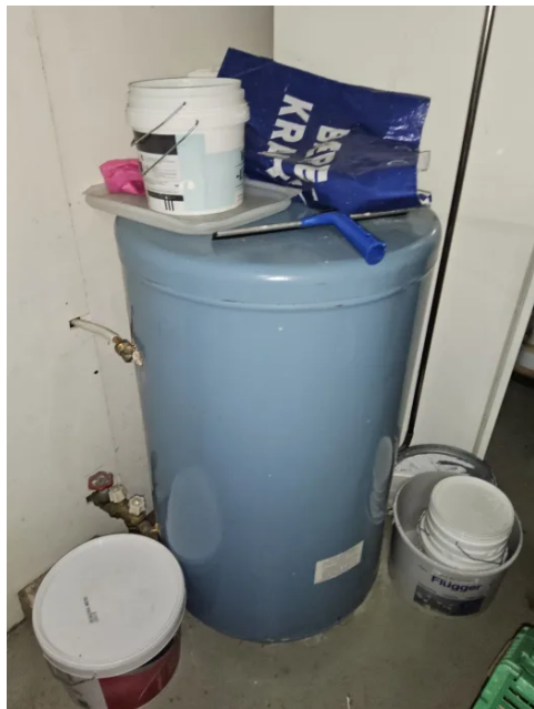
Bilde viser varmtvannsbereder.
