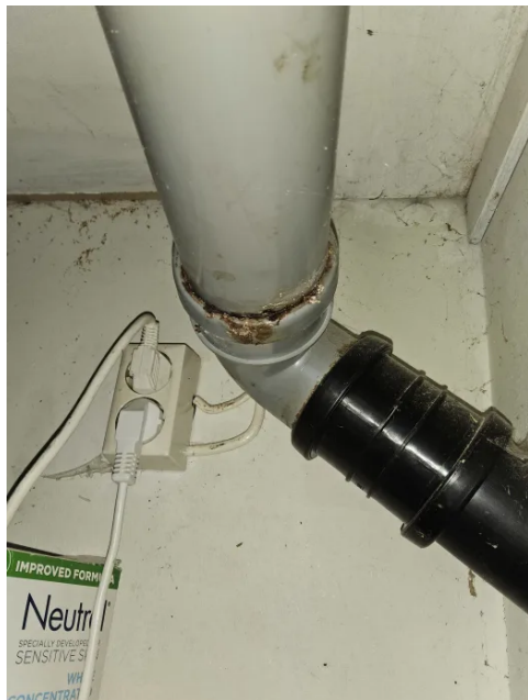
Bilde viser tegn til lekkasje fra rørskjøt.
