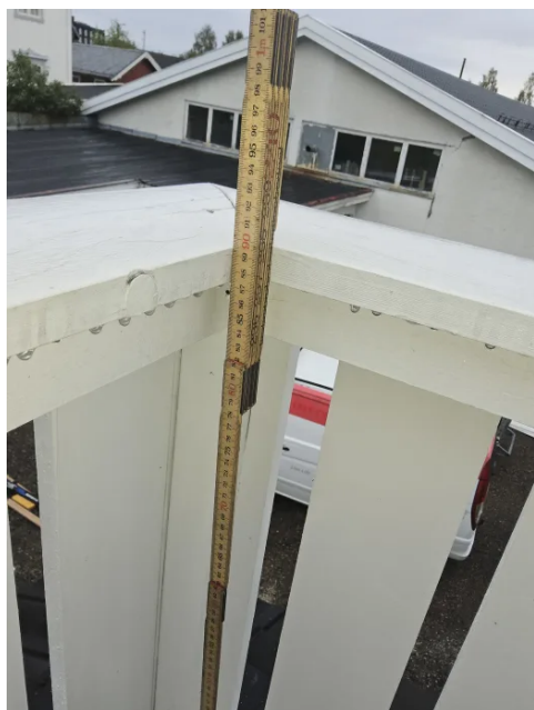
Bilde viser lavt rekkeverkshøyden.
