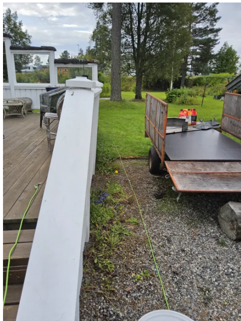
Bilde viser skjevhet i rekkeverk.
