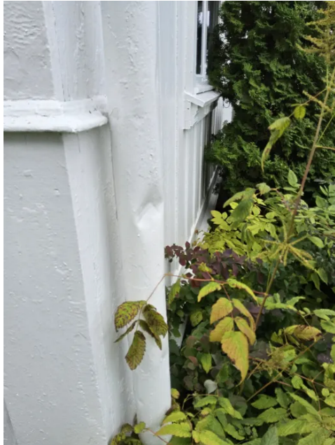
Bilde viser skade i nedløpsrør.
