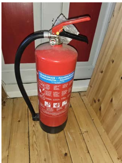
Bilde viser brannslukningsapparat.
