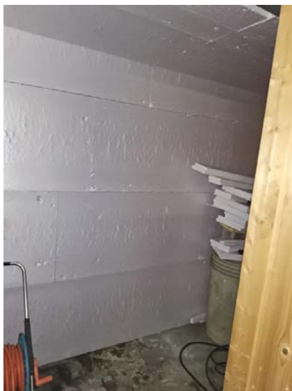
Bilde viser isopor på vegg/himlingsflater.
