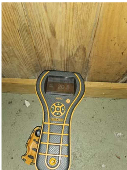
Bilde viser fuktmåling i utlektet kjellervegg.
