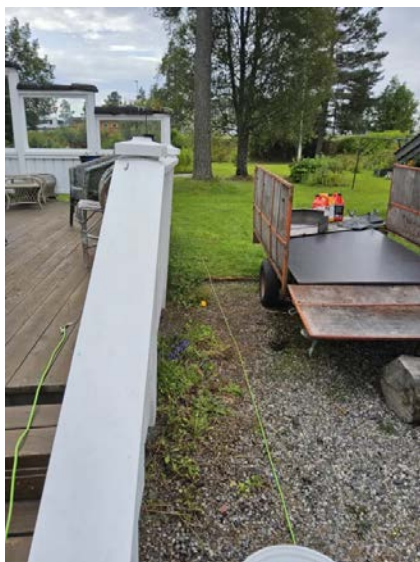
Bilde viser skjevhet i rekkverk.
