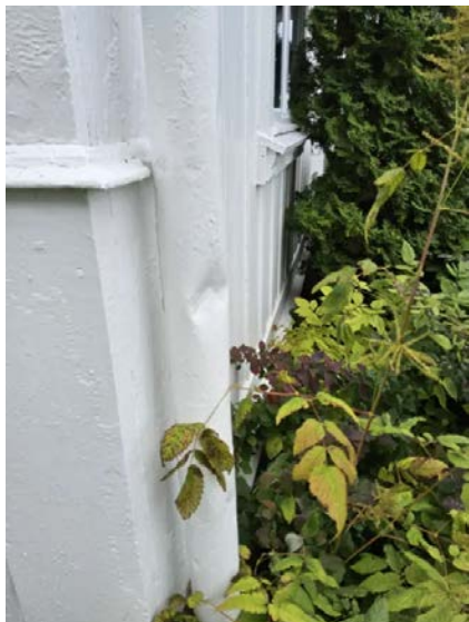
Bilde viser skade i nedløpsrør.
