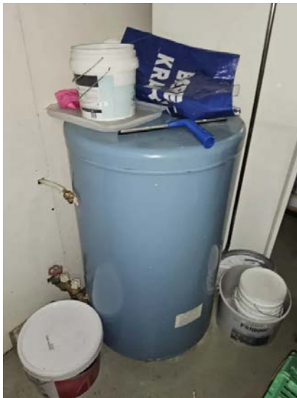
Bilde viser varmtvannsbereder.
