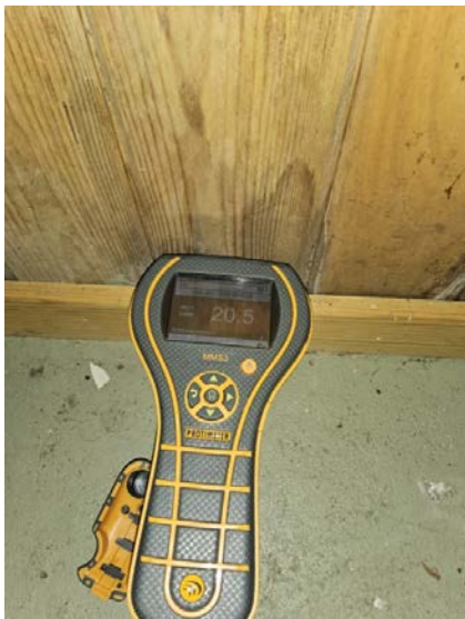
Bilde viser fuktmåling i utlektet kjellervegg.
