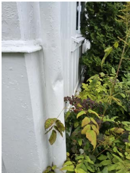
Bilde viser skade i nedløpsrør.
