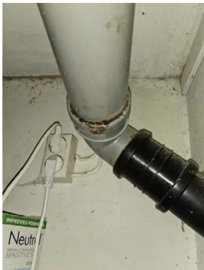
Bilde viser tegn til lekkasje fra rørskjøt.
