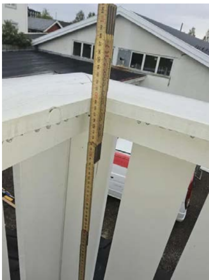
Bilde viser lavt rekkeverkshøyden.
