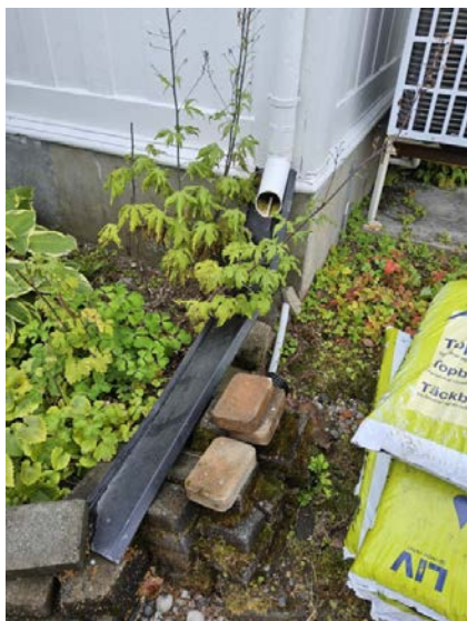
Bilde viser taknedløp avsluttet over bakken.
