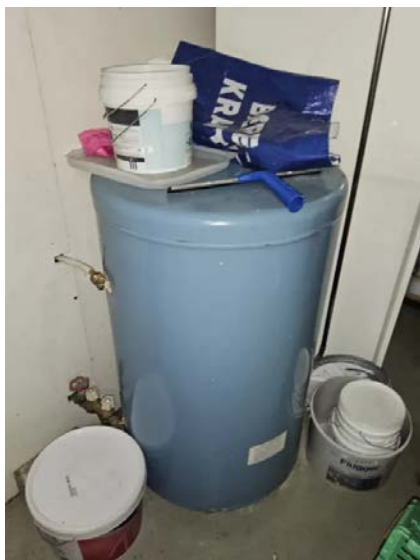
Bilde viser varmtvannsbereder.
