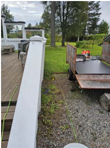
Bilde viser skjevhet i rekkeverk.
