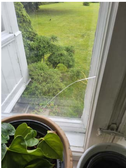
Bilde viser sprekk i glass.
